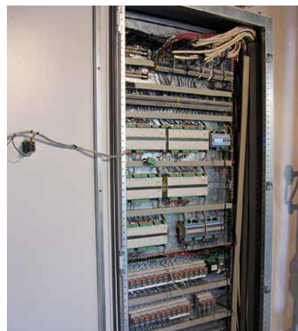
Rozvaděč MaR s I/O moduly a podstanic při uvádění do provozu
