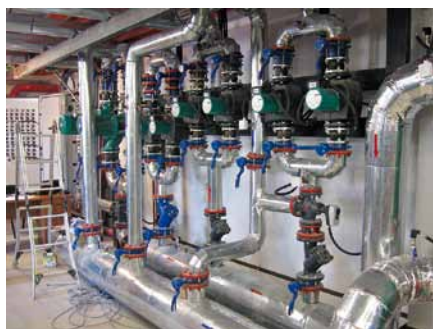
Hlavní rozdělovač, vlevo rozvaděč silnoproudu
